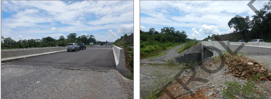
Figura 8. PIV El CAIS: Subestructura y superestructura completas. Obras de acceso y de aproximación sin avance.
