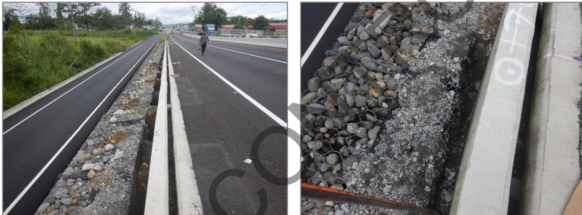
Figura 6. Intercambio de Guápiles, deterioro de canastas de gaviones por mal procedimiento constructivo de postes para sistemas de contención vehicular.
