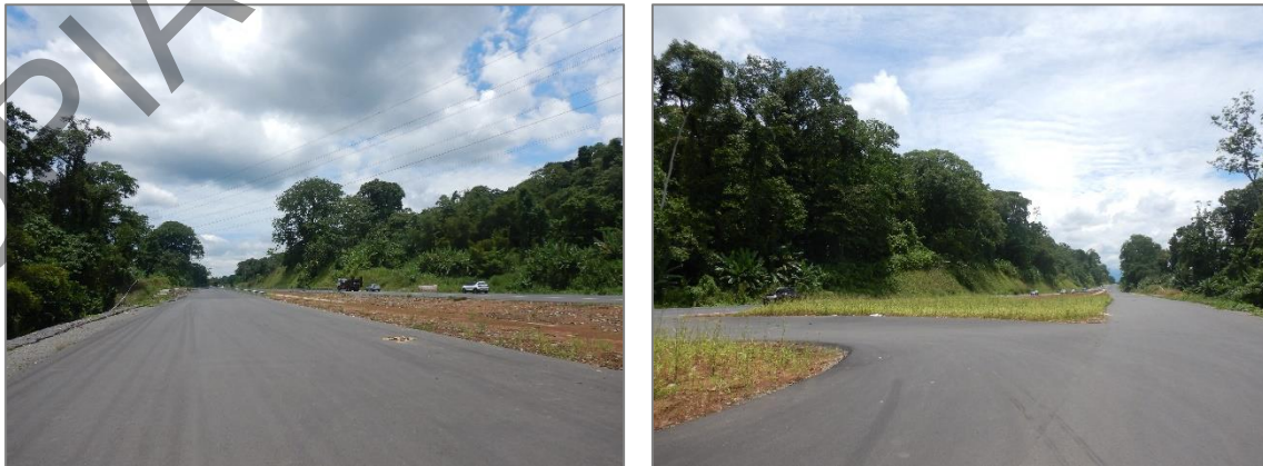
Figura 9. Retorno en el estacionamiento 103+150 pendiente de sistemas de contención vehicular, señalización vertical y demarcación vial, a pesar de haberse reportado como 100% concluido.
