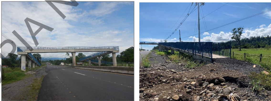
Figura 2. Paso Peatonal La Marina, falta de accesos de ingreso y salida al puente.
