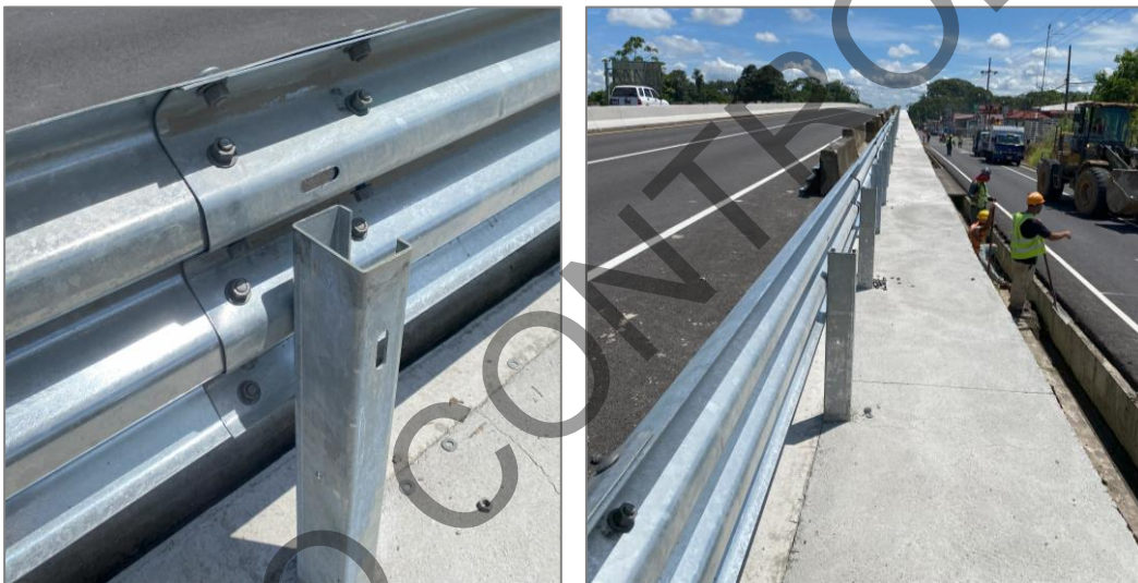
Figura 9. Colocación de postes para sistemas de contención vehicular en la sección superior del intercambio de Guápiles.
