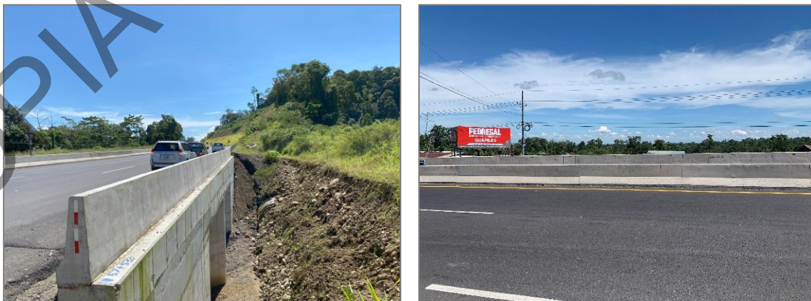
Figura 5. Estado del paso inferior vehicular en la comunidad de Danta.
