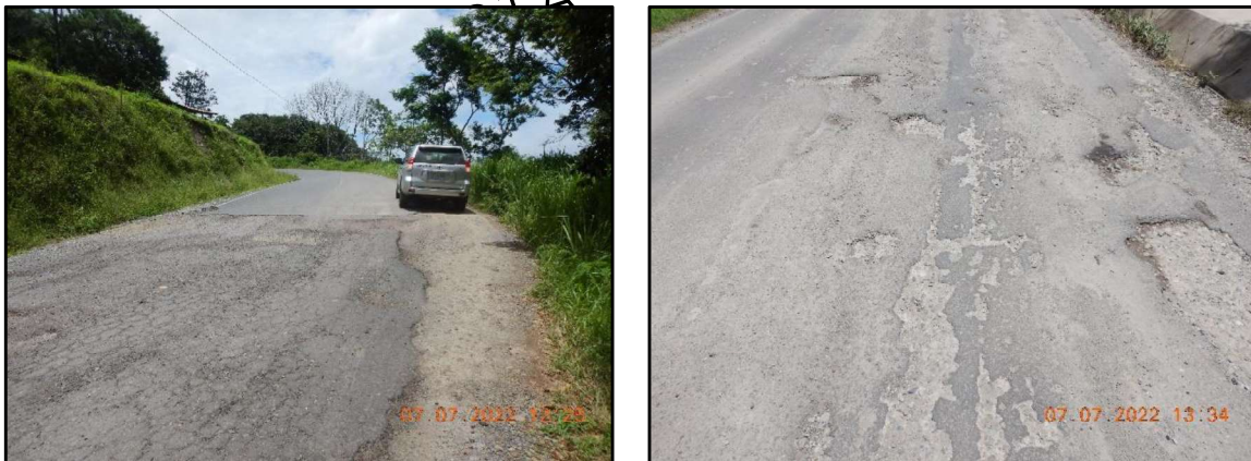
Figura 1. Mal estado de secciones amplias de la superficie de rodamiento de la ruta.
