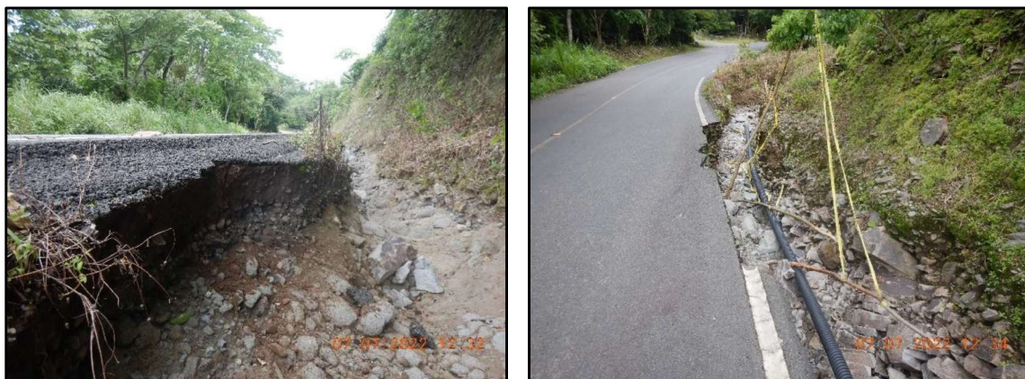
Figura 11. Costado de la vía inseguro para los usuarios del sistema de transporte.
