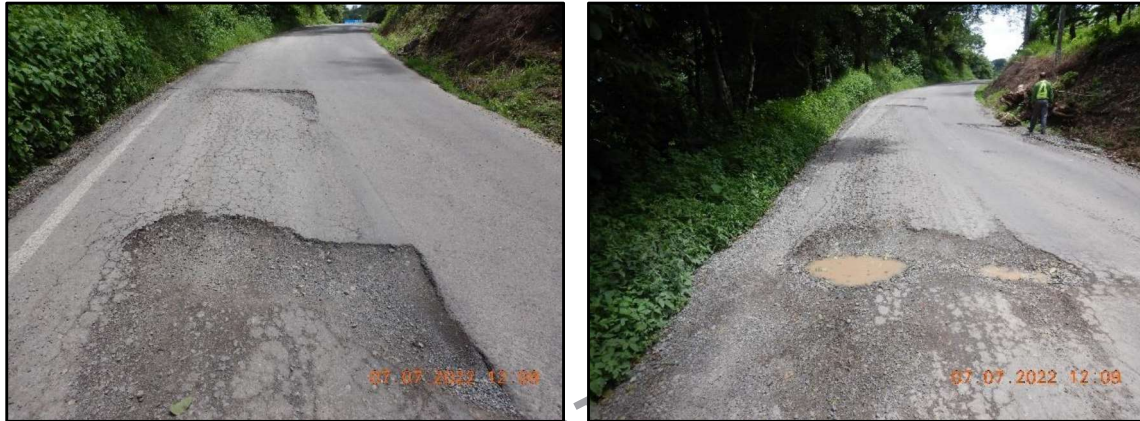
Figura 10. Deterioros relacionados con geometría curva e inclinada de la vía y la ausencia de sistemas de evacuación de aguas (cunetas).
