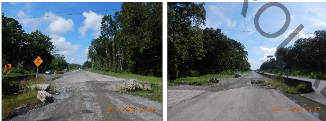
Figura 2. Ausencia de dispositivos o señalización vertical de restricción de paso a la zona de trabajo de colocación de asfalto en Búfalo.
