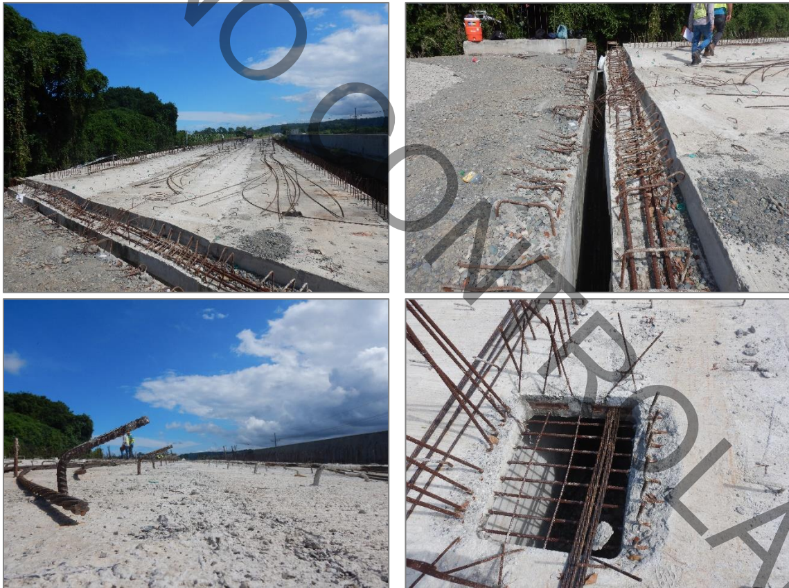
Figura 3. Deterioros significativos en la losa de las obras de rehabilitación en el puente sobre el Río Cuba.
