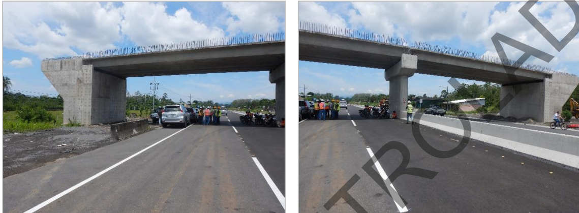
Figura 5. PSV Pocora: Subestructura terminada y avance en superestructura del paso vehicular superior.
