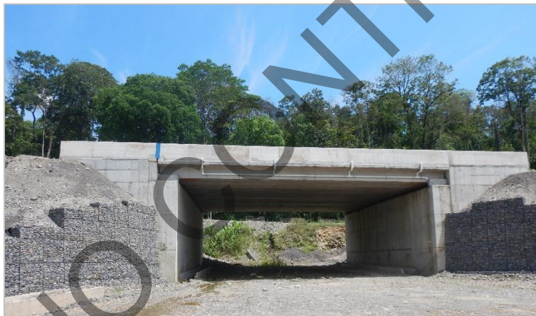
Figura 7. PIV El CAIS: Subestructura y superestructura completas. Obras de acceso y de aproximación pendientes.
