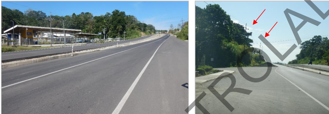
Figura 8. Retorno frente al INA: Avance considerable de la obra y pendiente de terrenos a expropiar para reubicación de servicios públicos y construcción de los carriles faltantes.
