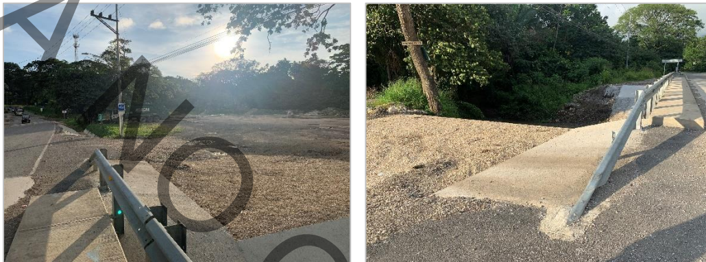
Figura 16. Longitud barrera posterior insuficiente sobre el puente Quebrada Sube y Baja para el flujo vehicular en sentido Nosara – Playa Garza.
