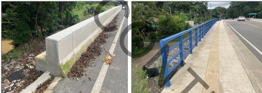
Figura 5. Terminales bruscos en puente sobre Río Esperanza.
