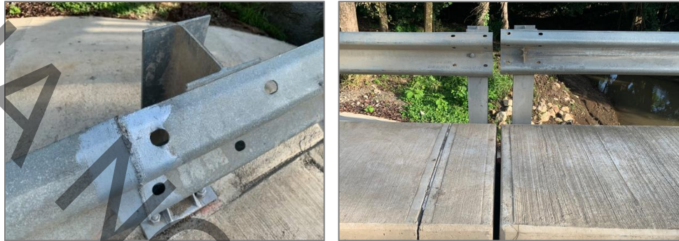
Figura 21. Falta de transiciones entre tramos de barreras (sin elementos de transición y soladas) en puente sobre Quebrada Sube y Baja.
