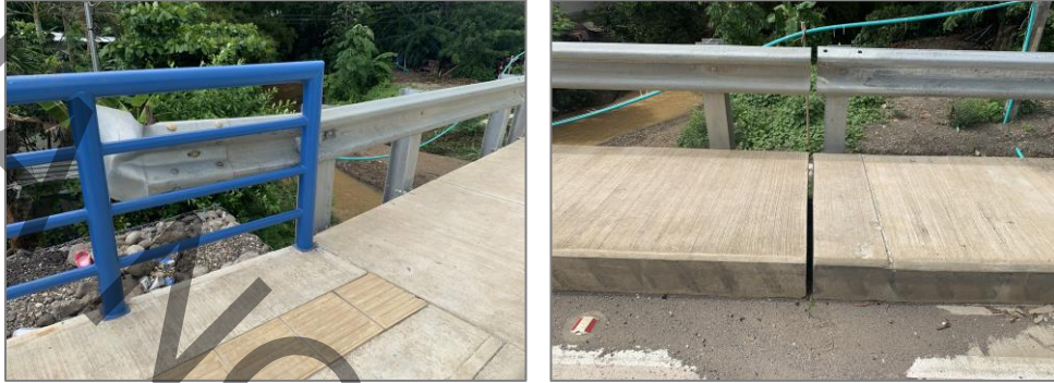
Figura 18. Uniones entre diferentes tipos de barreras sin elementos de transición en puente Río Esperanza.
