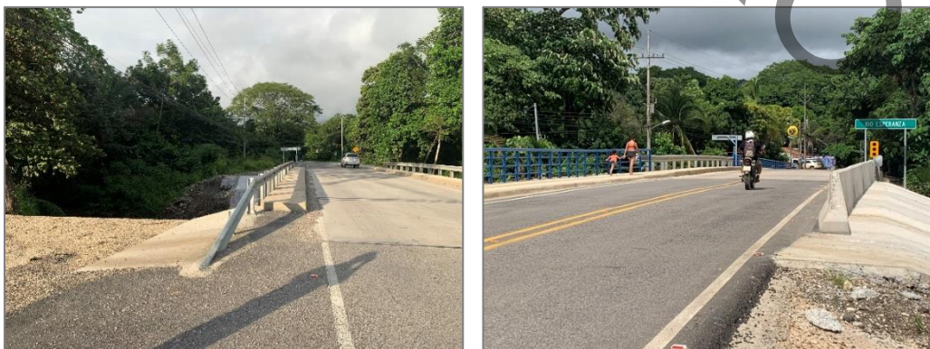
Figura 10. Ausencia de razón de esviaje en las terminales de los SCV de los tres puentes construidos. Puente Quebrada Sube y Baja y Puente sobre Río Esperanza.
