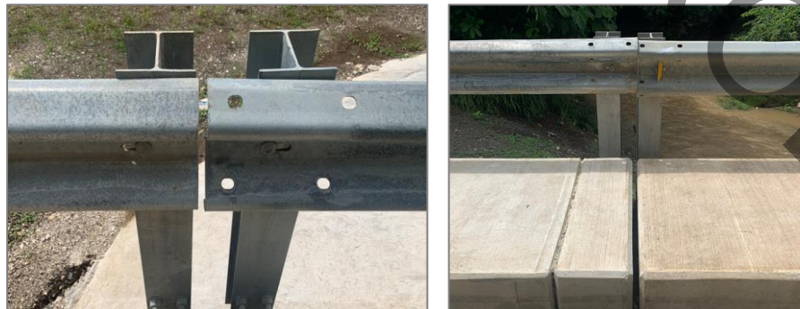
Figura 20. Falta de transiciones entre tramos de barreras (sin elementos de transición) en el puente sobre Río Rempujo.
