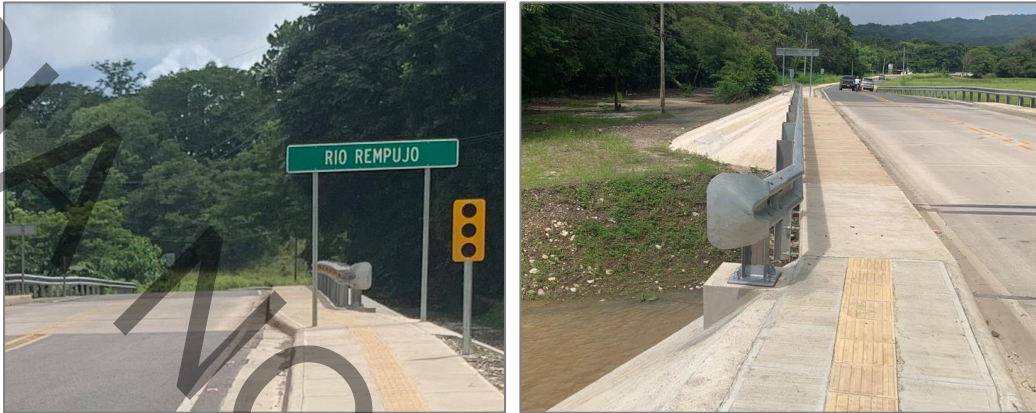
Figura 6. Terminales bruscos en puente sobre Río Rempujo.
